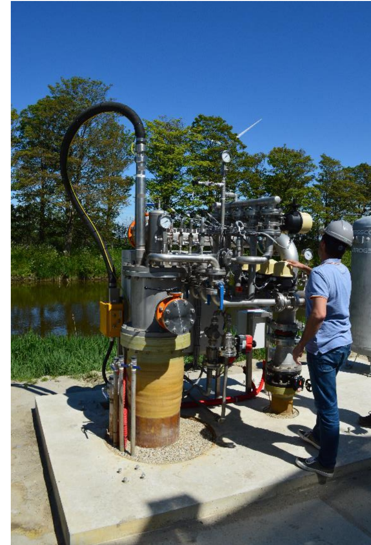
HT-bron met peilbuizen
